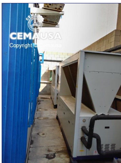
Grupo refrigeración agua 62000 frigorías/h.
